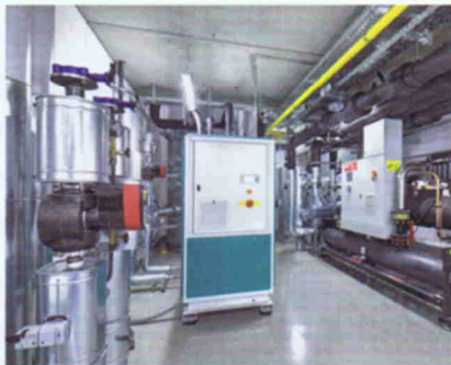
Bild 4: Das Zusammenspiel der einzelnen Heizungs-, Kühl- und Lüftungskomponenten wird über einen Bus energieeffizient geregelt. Hier abgebildet ist die Druckluftherzeugung und die Kältemaschine. Bild: SMP
