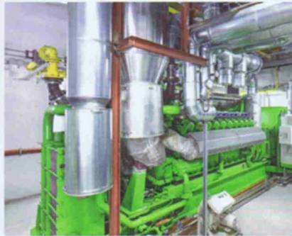
Bild 2: Um ausreichend Energie für die Heizung der Büroräume zu erhalten, nutzt Gammel die Abwärme des erdgasbetriebenen BHKWs auf dem benachbarten Hauptwerksgelände. Durch die Nutzung der Abwärme steigert sich die Energieeffizienz des bestehenden BHKWs nochmals. Bild: Gammel
