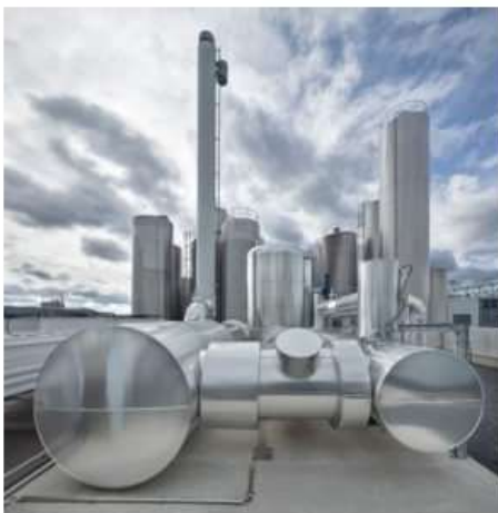
Dachaufbauten der neuen Energieversorgung der MW Oberfanken West
