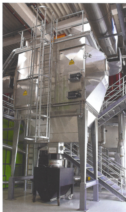
Durch die Verbrennung entsteht Prozesswärme, die als Dampf zu den verschiedenen Prozessstationen des Brauergeländes geführt wird.
