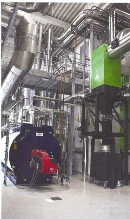
Schon vor 15 Jahren hat die Weissbierbrauerei Schneider einen eigenen Weg eingeschlagen: Für die zukunftssichere Versorgung leistete sich der Bierhersteller eine neue Energiezentrale mit Biomasseheizwerk. Bild: Gammel Engineering
