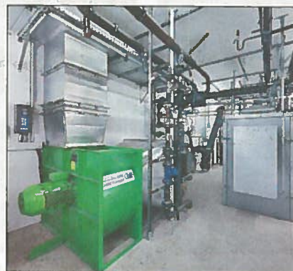
Warmluftversorgung für die Trocknung
