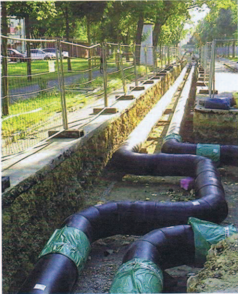
Das Fernwärmenetz der Stadtwerke Landshut versorgt auch Kunden in der historischen Innenstadt.
