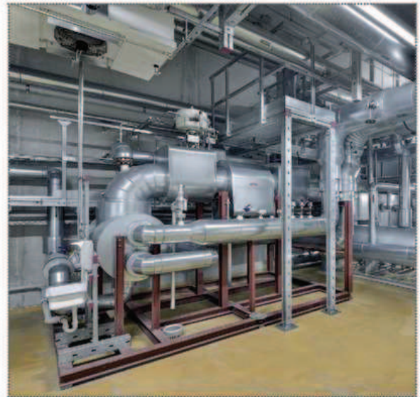
Ein Reindampferzeuger mit einer Leistung von 500 kg/h wandelt den Dampf in Reindampf für Prozesse um; ein Heizkondensator generiert 95 °C heißes Wasser zum Heizen.
