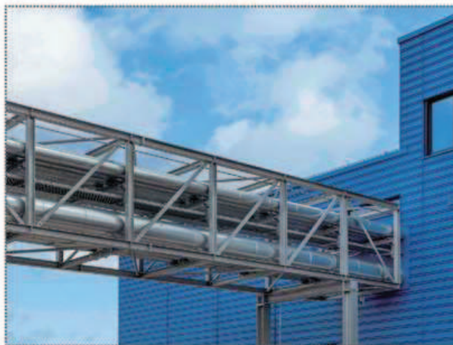
Die Rohrbrücke schließt direkt am Technikhaus an und führt den Dampf innen ins Untergeschoss zur Aufbereitung.
