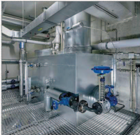
Ein Wärmetauscher mit einer besonders großen Tauscherfläche wurde installiert, um einen besseren Wärmeübergang ohne Druckverlust zu erzielen.
